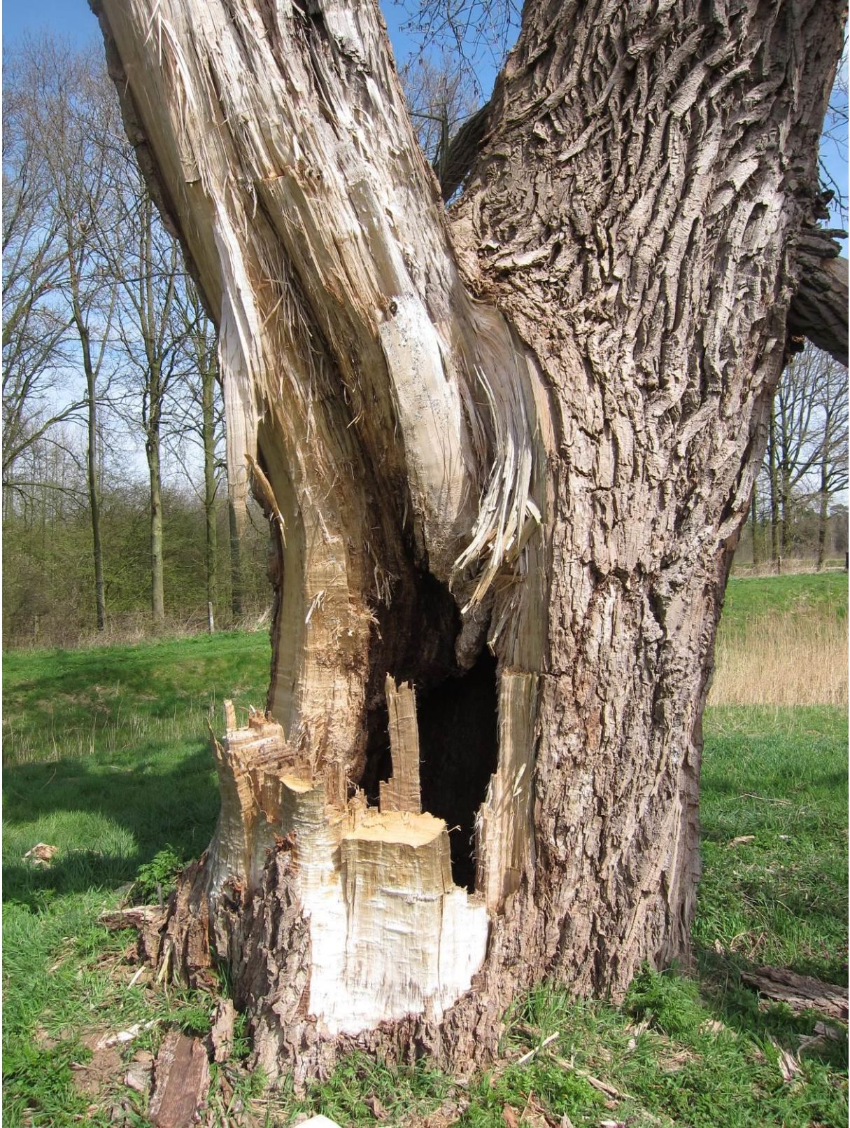
Fig. 36. Bij het begin van het omleidingskanaal staat een grote zwarte populier waarvan in 2016 een groot deel is afgescheurd en waarna bleek dat de peppel hol is. Al in 1996 had het een omvang van meer dan 5 meter.
